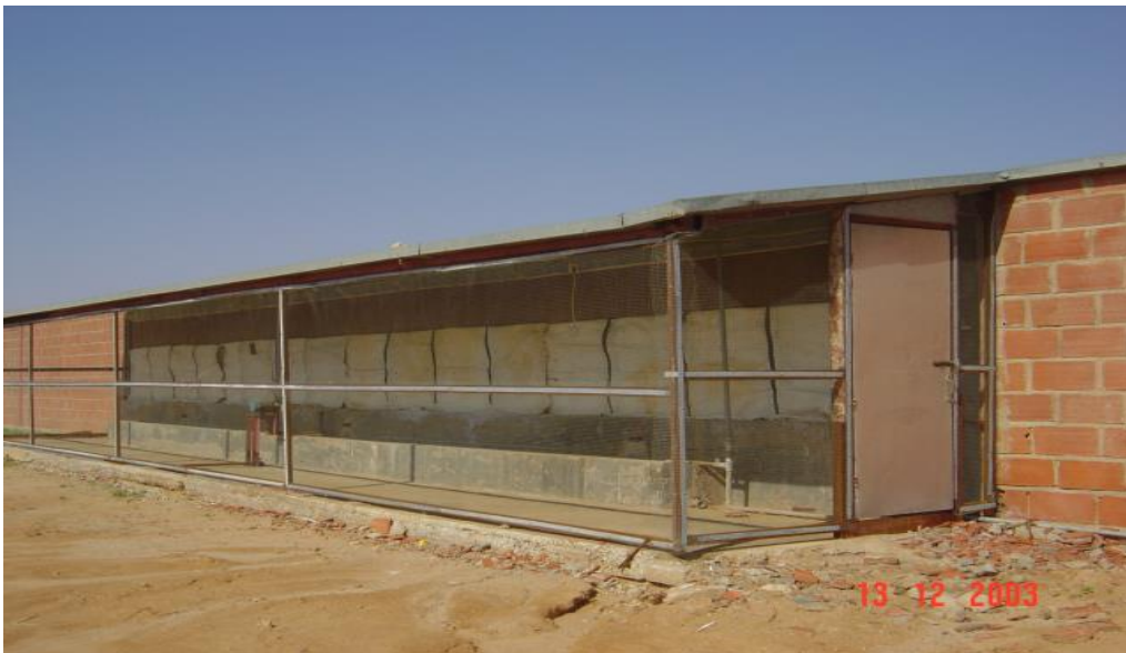
الشكل يوضح تركيب شبكة من الأسلاك لحماية خلايا التبريد من الخارج ومنع وصول الطيور البرية إليها
