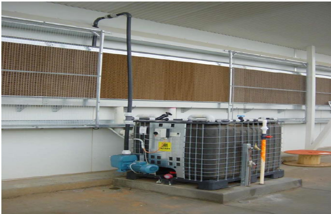
الشكل يوضح خزان ودورة المياه في خلايا التبريد
