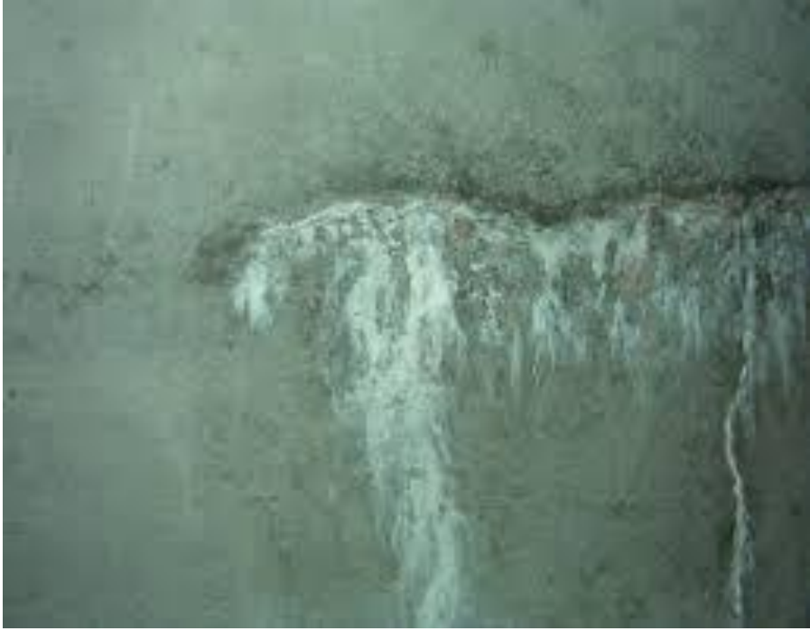
-Efflorescence- التزهير Leaks through cracks
